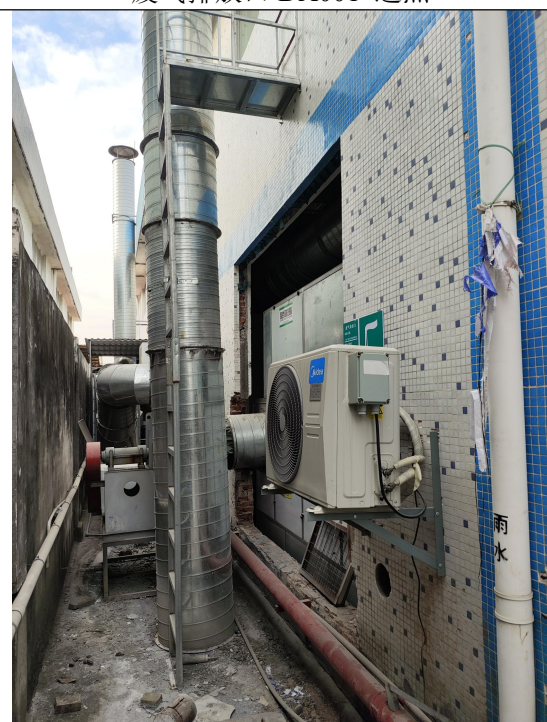
废气排放口 DA002 远照
