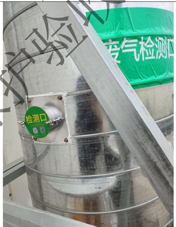
废气采样孔（处理后）
