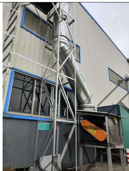
废气排放口 DA001 远照
