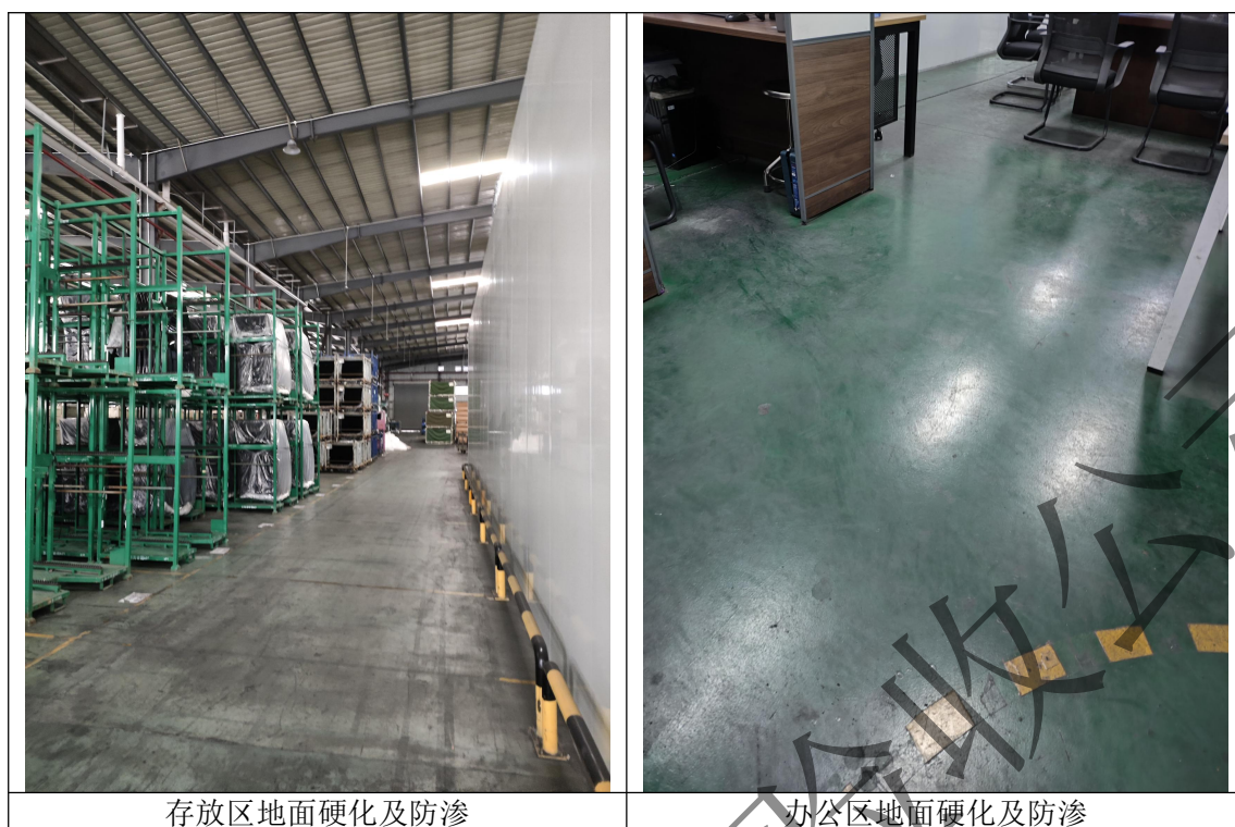
图 4.2-2 区域防渗措施现场情况
