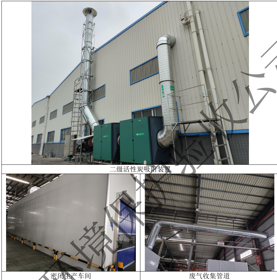
图 4.1-3 废气治理设施现场照片
