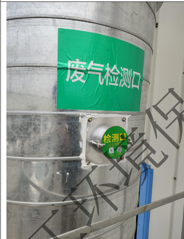
废气采样孔（处理前）
